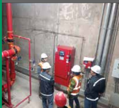
BOMBA CONTRA INCENDIO
